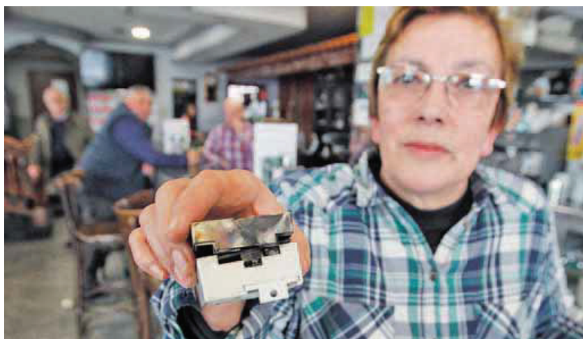
La dueña del mesón La Muralla, mostrando un diferencial eléctrico quemado. FOTOS JOSÉ PARDO
