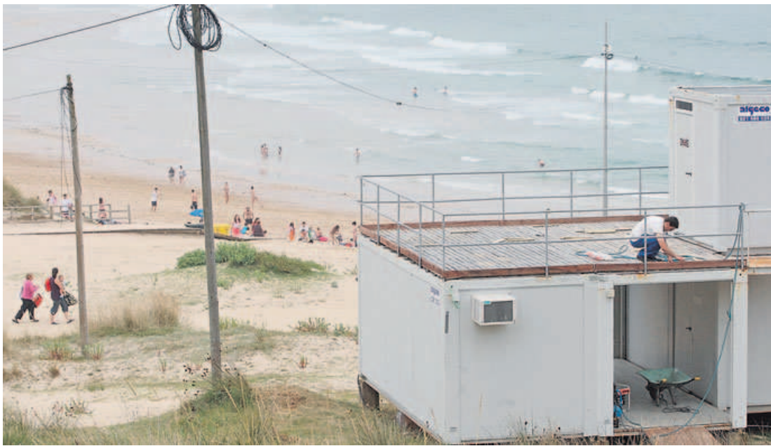
Bañistas en Doniños mientras se efectúan reparaciones en la caseta de socorrismo que estará ocupada desde el domingo. JOSÉ PARDO
