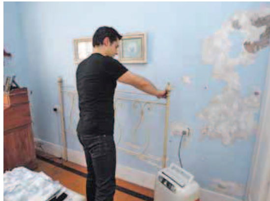
Emilio M. Pardo en su casa afectada por las filtraciones. CÉSAR TOIMIL
