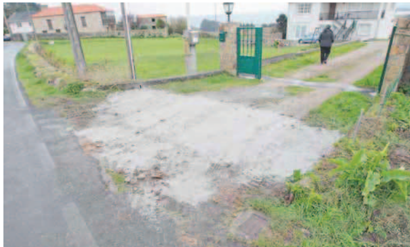
Entrada de la vivienda, donde hace unos días se realizaron obras para una compañía telefónica. JOSÉ PARDO
