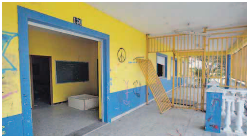
Aspecto actual del antiguo CEIP Tomás Serantes, sin vallado de protección y desmantelado. CÉSAR TOIMIL
