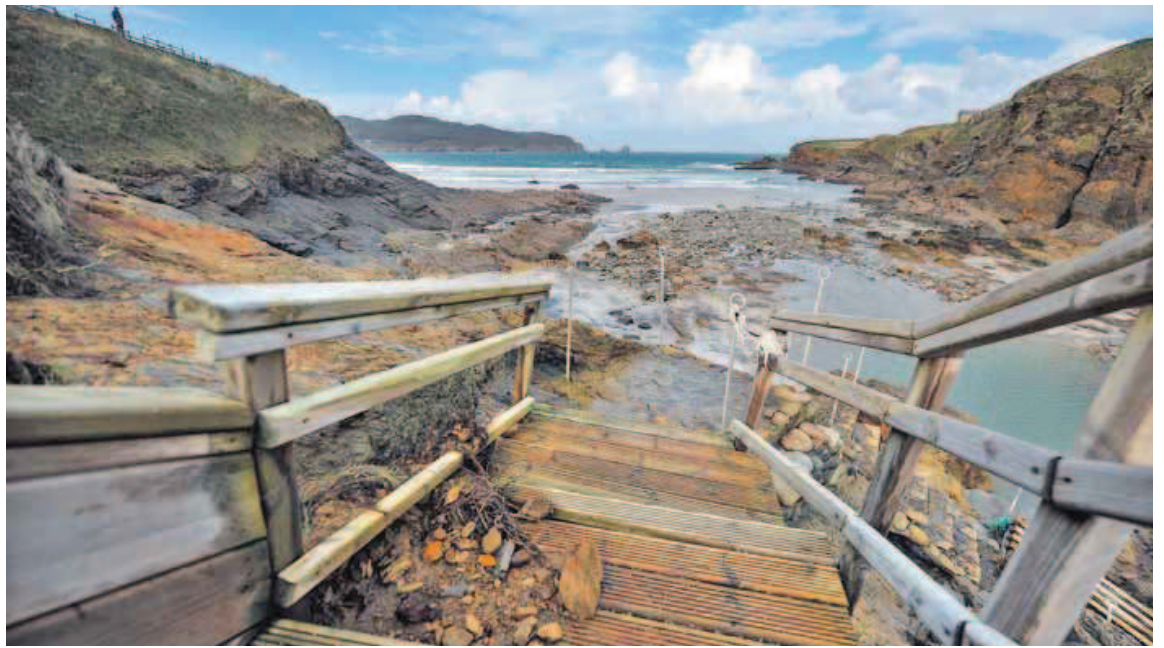
En la zona de Santa Comba la furia del mar, además de destruir el arenal, dejó inservibles las escalinatas de acceso a la playa. ÁNGEL MANSO
