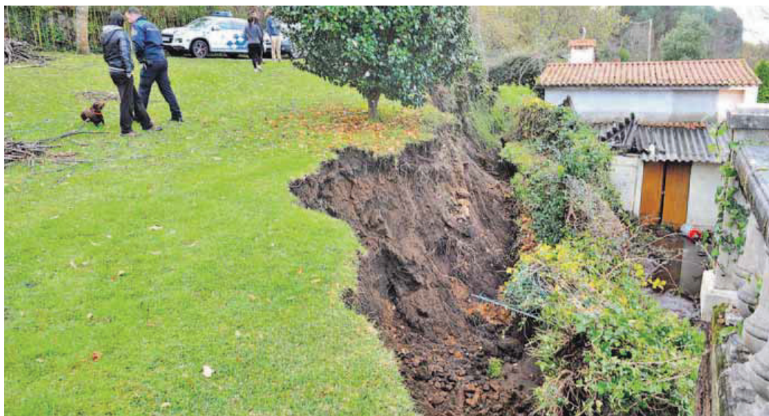
El desprendimiento de las tierras destruyó el muro de contención y alcanzó uno de los tejados de la propiedad. ÁNGEL MANSO
