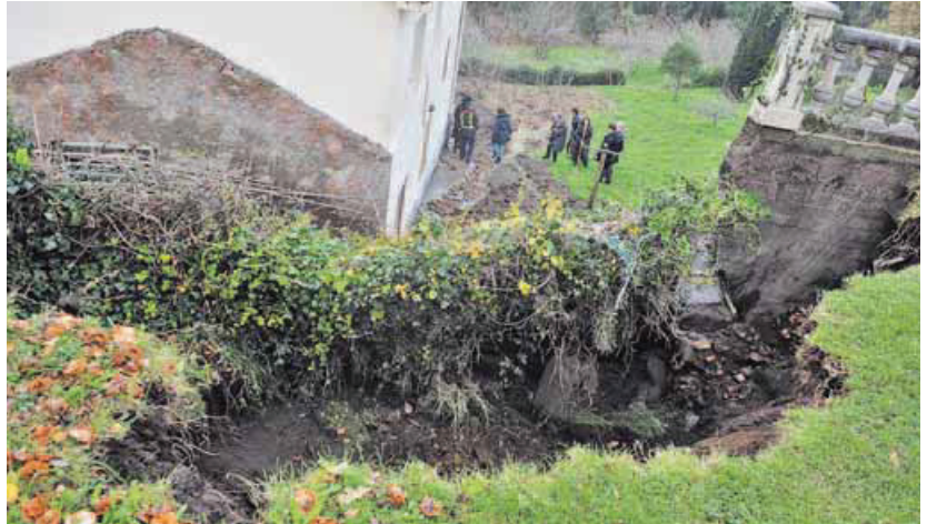
El desprendimiento de tierras derribó el muro de contención y afectó a un tejado. ÁNGEL MANSO
