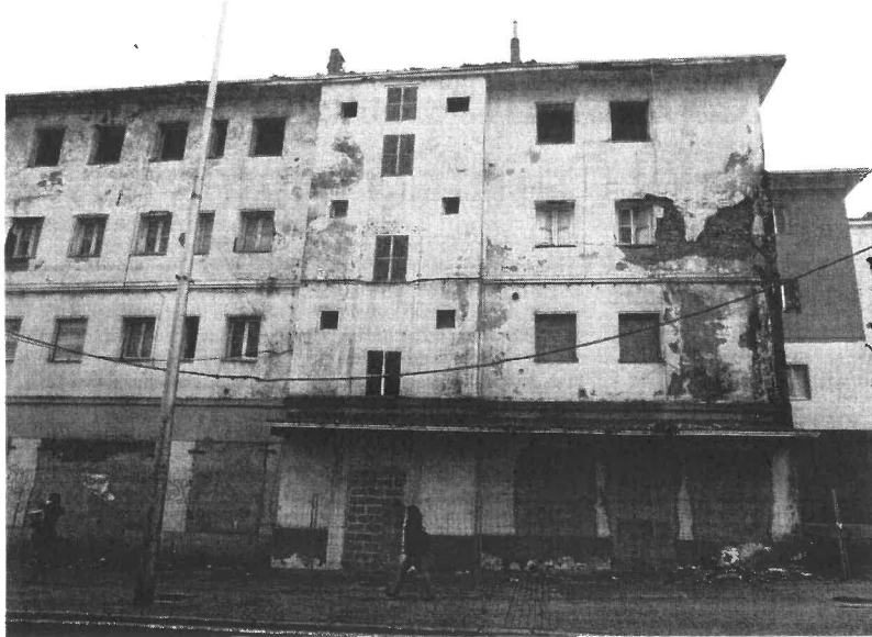
El Bambú Club se encuentra tapiado ante su avanzado estado de deterioro
